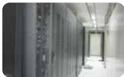
コロケーションルーム
