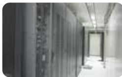
コロケーションルーム
