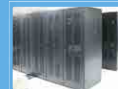
コロケーションルーム
